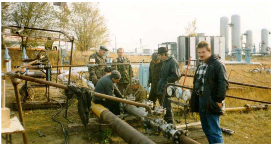
Рисунок 3 - Монтаж экспериментальной установки (ТЛ с независимым внешним контуром) на открытой площадке ССУД МТ "ОРГЭНЕРГОГАЗ"
